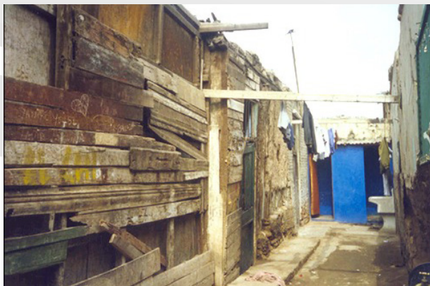
Imagen #1 Barrios Altos - Cercado de Lima: Viviendas tugurizadas e insalubres a punto de colapsar.
