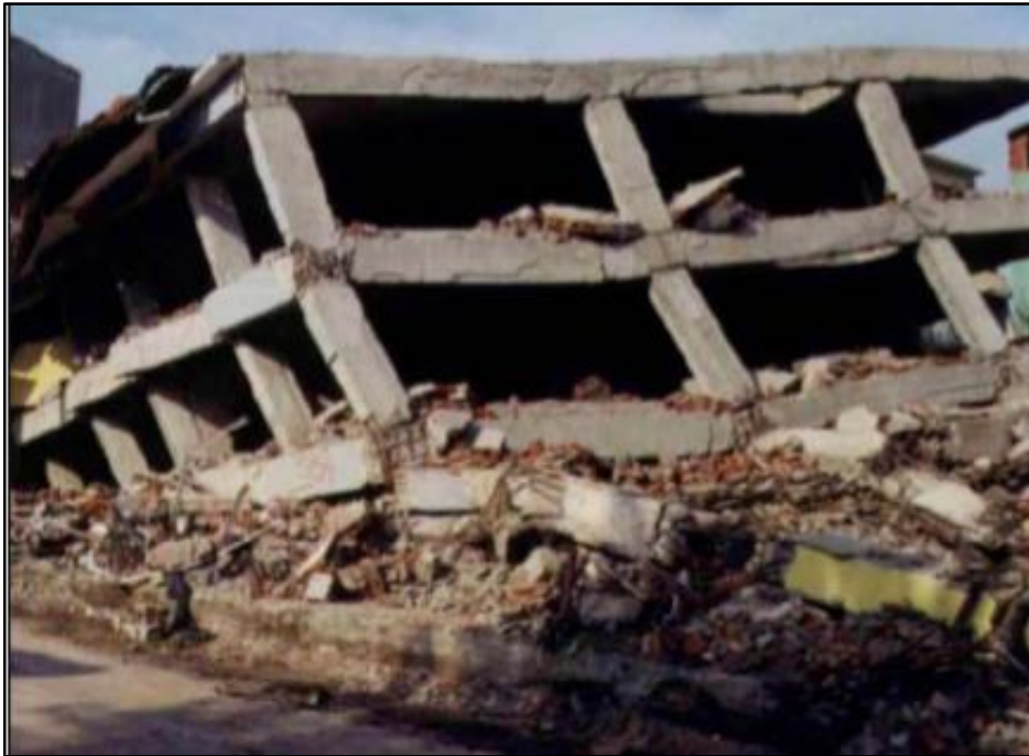
Figura 2. Colapso de edificio por falla en las conexiones entre los elementos estructurales en Izmit-Turquía (1999). Fuente: (Publins Canessa, 2008).
