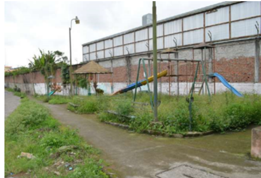
Imagen N° 7: Parques en mal estado. Fuente: (La hora, 2015)
