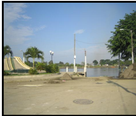
Fotos 11: Malecón No Regenerado Muelle en mal estado
