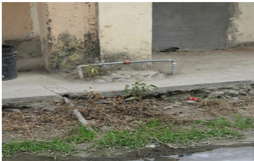
Figura 3.13. En las figuras anteriores podemos observar la inexistencia de medidores en muchas de las acometidas domiciliarias de agua potable. Fuente: Autoría Propia
