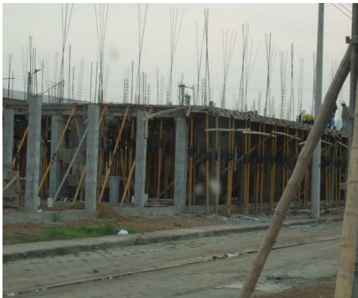
Foto 152, Trabajos de construcción con sistema tradicional de pórticos de hormigón armado. Fuente: G. Pérez/S. Almeida
