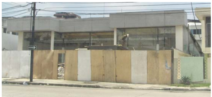
Foto 90, Readecuación de vivienda existente en calle Guayacanes y Av. Las Monjas, URDESA. Fuente:G. Pérez/S. Almeida
