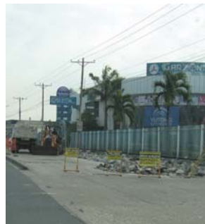
Foto 118, Escombros de aceras de la Av. De Las Américas. Fuente: G. Pérez/S. Almeida
