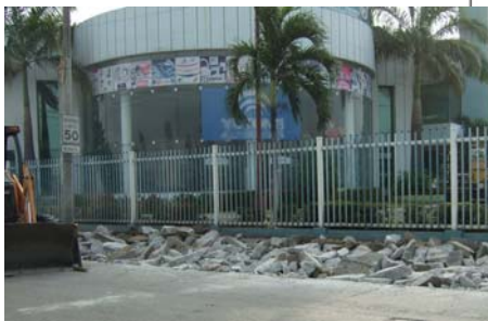
Foto 70. Trabajos de restitución de aceras y bordillos, Av. De Las Américas. Fuente: G. Pérez/S. Almeida
