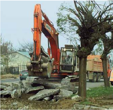
Foto 28, Extracción de hormigón proveniente de pavimentos. Fuente Hector Montoya, Investigación Reutilización de residuos de hormigón.
