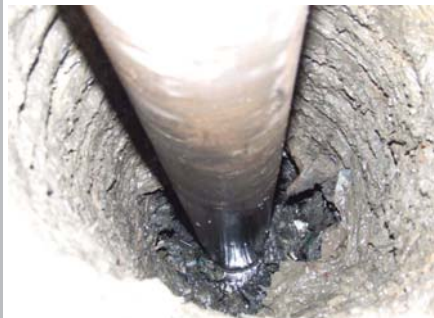
Foto 95, Trabajos de perforación en el Relleno Sanitario Fuente: Eastern Research Group, Inc y Carbon Trade, Ltd. 2007.
