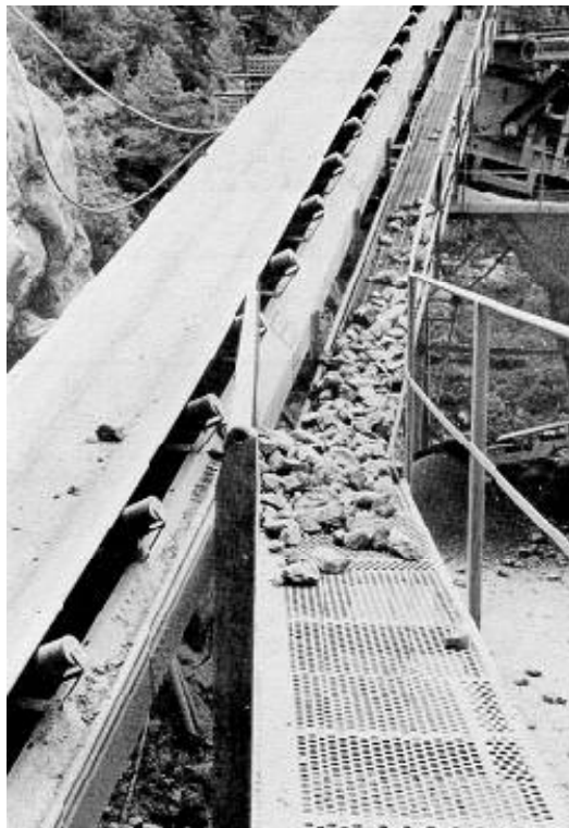
Foto 19. Cinta transportadora y pasarela obstruida por residuos. Fuente: Pedro Sabaté Carreras, NTP 127: Estación de trituración primaria, Ministerio de trabajo y Asuntos Sociales, España.
