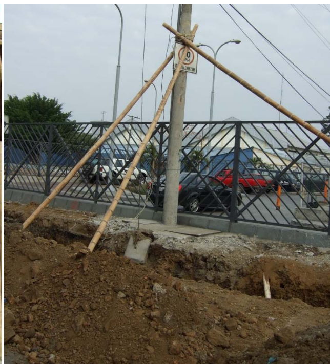
Foto 9. Luminaria pública apuntalada con caña durante trabajos de demolición, Av. De Las Américas, Guayaquil, 2008. Fig. 11 Fuente: G. Pérez/Sebastián Almeida
