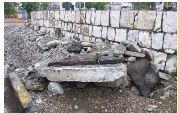
Foto 120, Escombros de aceras de la Av. De Las Américas. Fuente: G. Pérez/S. Almeida
