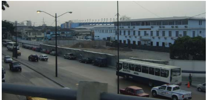
Foto 87, Demolición del edificio de oficinas de la Policía Nacional, Av. De Las Américas Fuente:G. Pérez/S. Almeida
